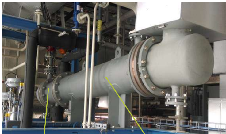
Kälteteil für Kondensatkühlung und Nachkondensation
