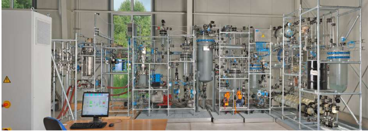
FAT der Pilotanlage im Zentralwerk Ilmenau
