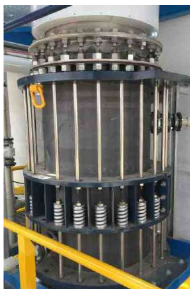
Sprühquenche DN800 in Anlage zur Verbrennung (Gastemperatur über 1000°C)
